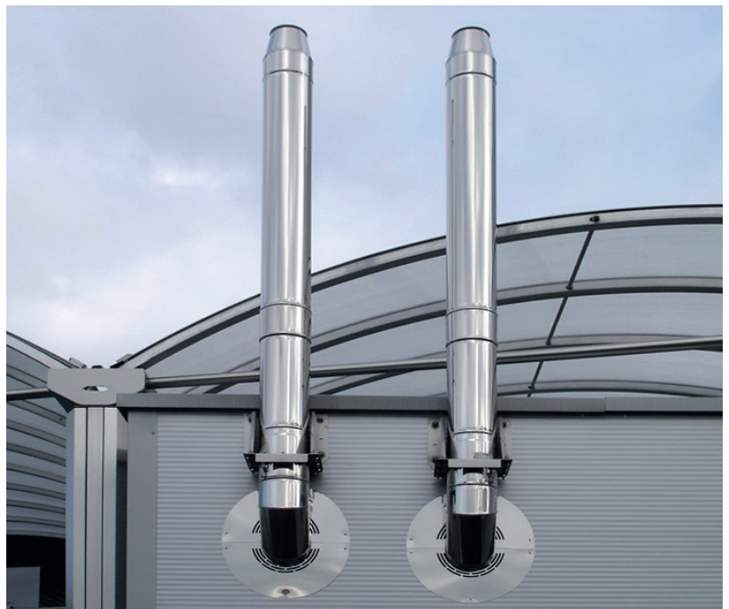
Bild 19: Kaminrohre erreichen im Inneren Temperaturen bis zu 650 °C (Foto: EKA-Edelstahlkamine GmbH, Untersteinach (D))
